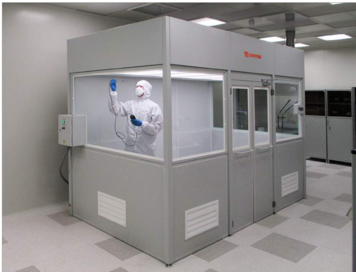
Чистая зона для сборки микросхем. Класс чистоты 3 ИСО по ГОСТ ИСО 14644-1 Габаритные размеры комплекса в сборе (ДхШхВ, мм) 1905х3105х2477
