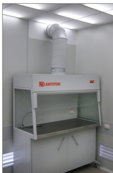
Комплекс оборудования КОЧ «Ламинар-С»-109
