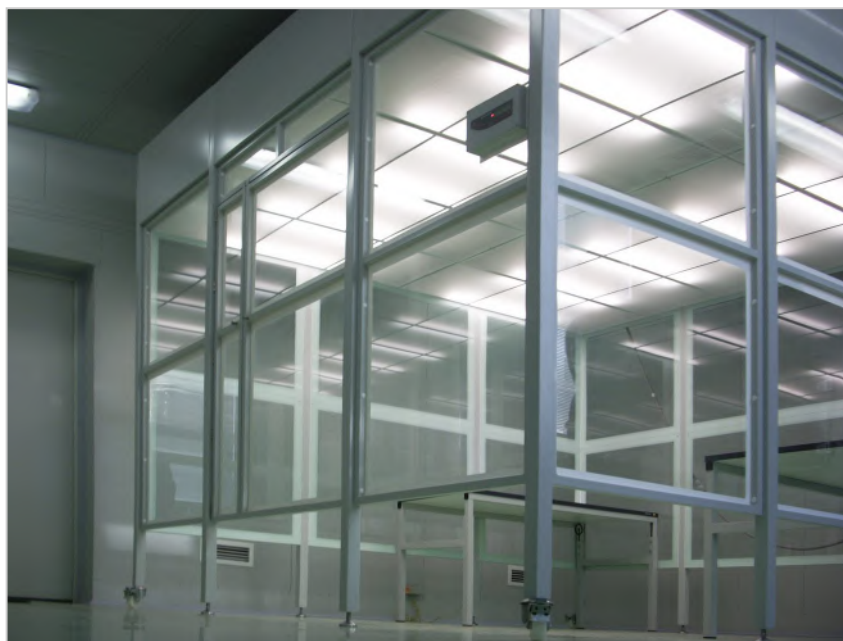
Комплекс оборудования КОЧ «Ламинар-С»-155
