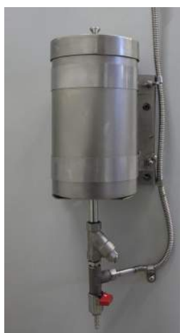
Заливная ёмкость для перекиси водорода крепится к стене помещения
