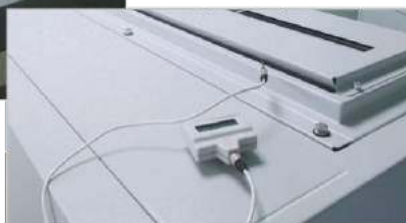
Измерение температуры выходящего воздушного потока
